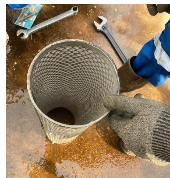
Gambar 10 Strainer kondisi bersih
